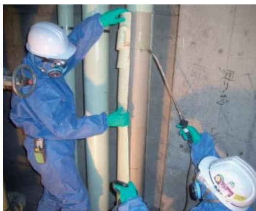
図34 保温材の湿潤化 33)
