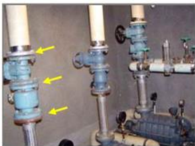
バルブ継ぎ手部などへのパッキン・ガスケット (継ぎ目に挟まっているため写真では見えない)
