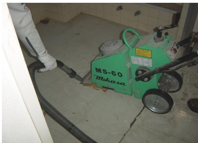
図41 HEPAフィルタ付真空掃除機を使用しながらのビニル床タイル除去作業
