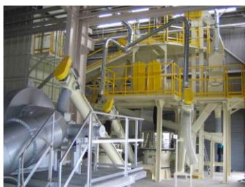
廃石膏ボード処理プラント
