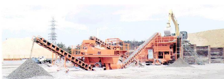
コンクリート廃材処理プラント
