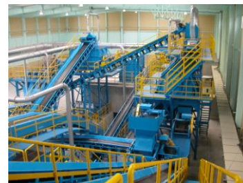
建設廃木材処理プラント
