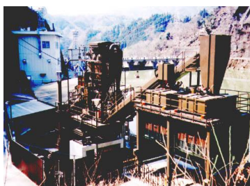
ダム塵芥処理プラント
